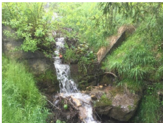
Abbildung 7: Betonsperre im Steilhang mit teilweise Mängel im Kolkbereich
