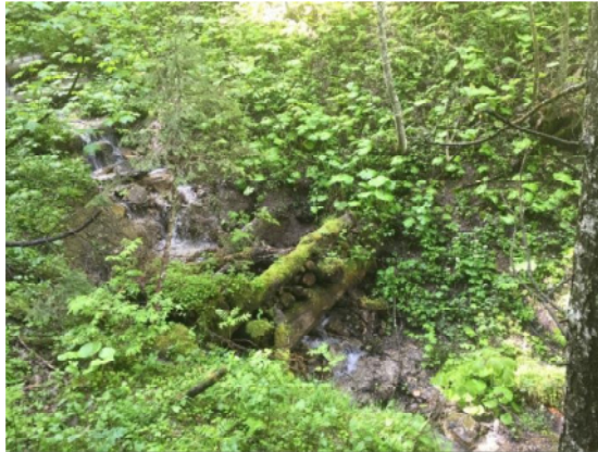
Abbildung 3: unterspülter Holzkasten oberhalb Senggistrasse
