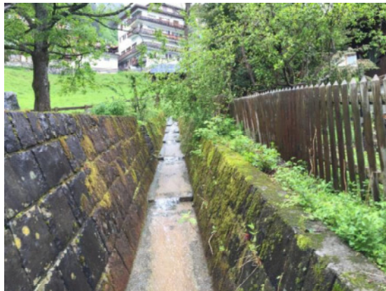
Abbildung 6: Schalenstrecke im Dorfbereich im guten Zustand
