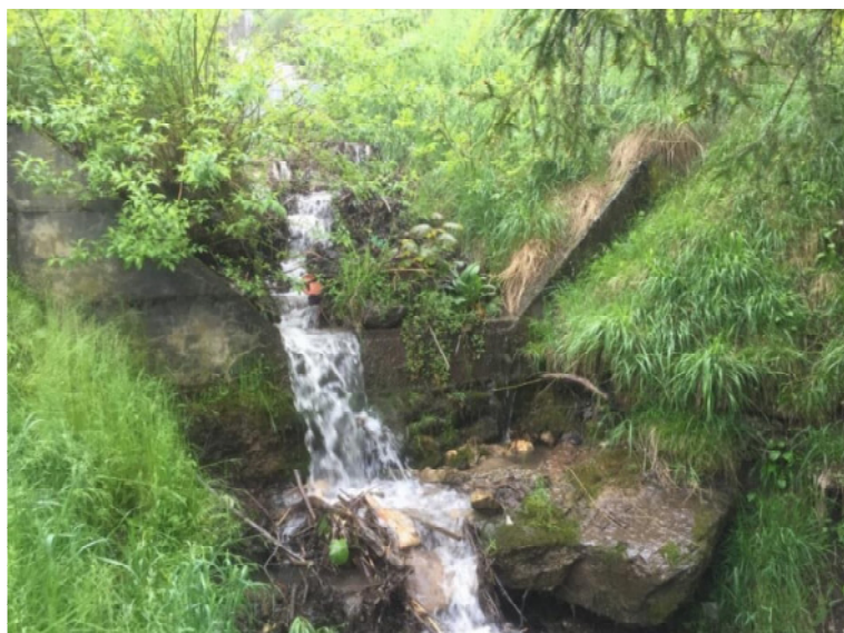
Abbildung 21: Foto Sperre in der Steilstrecke mit teilweise Erosion Unterstrom der Sperre -> Kolkbereiche sichern
