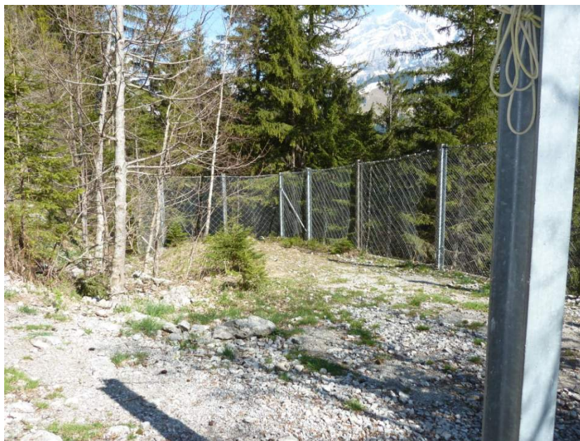
Abbildung 18: Under der Flue -Netz auf Galerie Stiegelschwandstrasse
